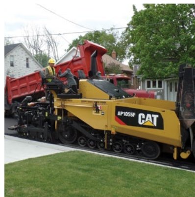
^ AP1055F/SE60 V XW Ulice v obytné zástavbě
